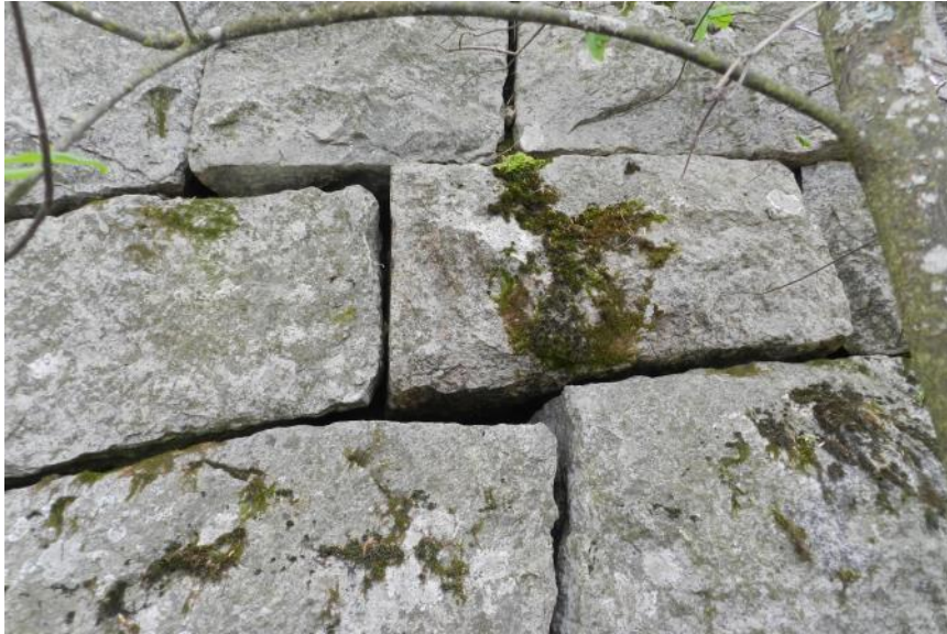
Figur 30 Glipor mellan stenarna.
