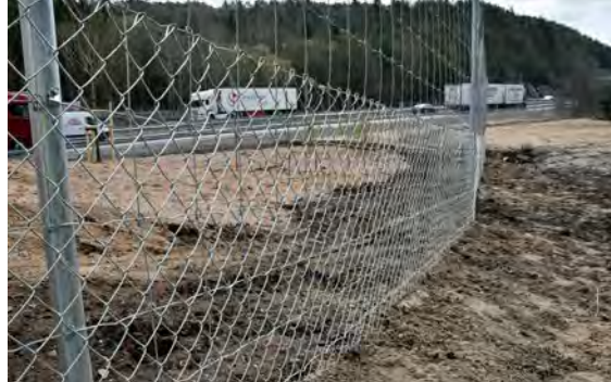
Figur 31 Bild på faunastängsel vid ekodukten. Det är ett viltstängsel med tätare nedgrävd nederdel så djuren inte kan gräva sig ut till vägen.
