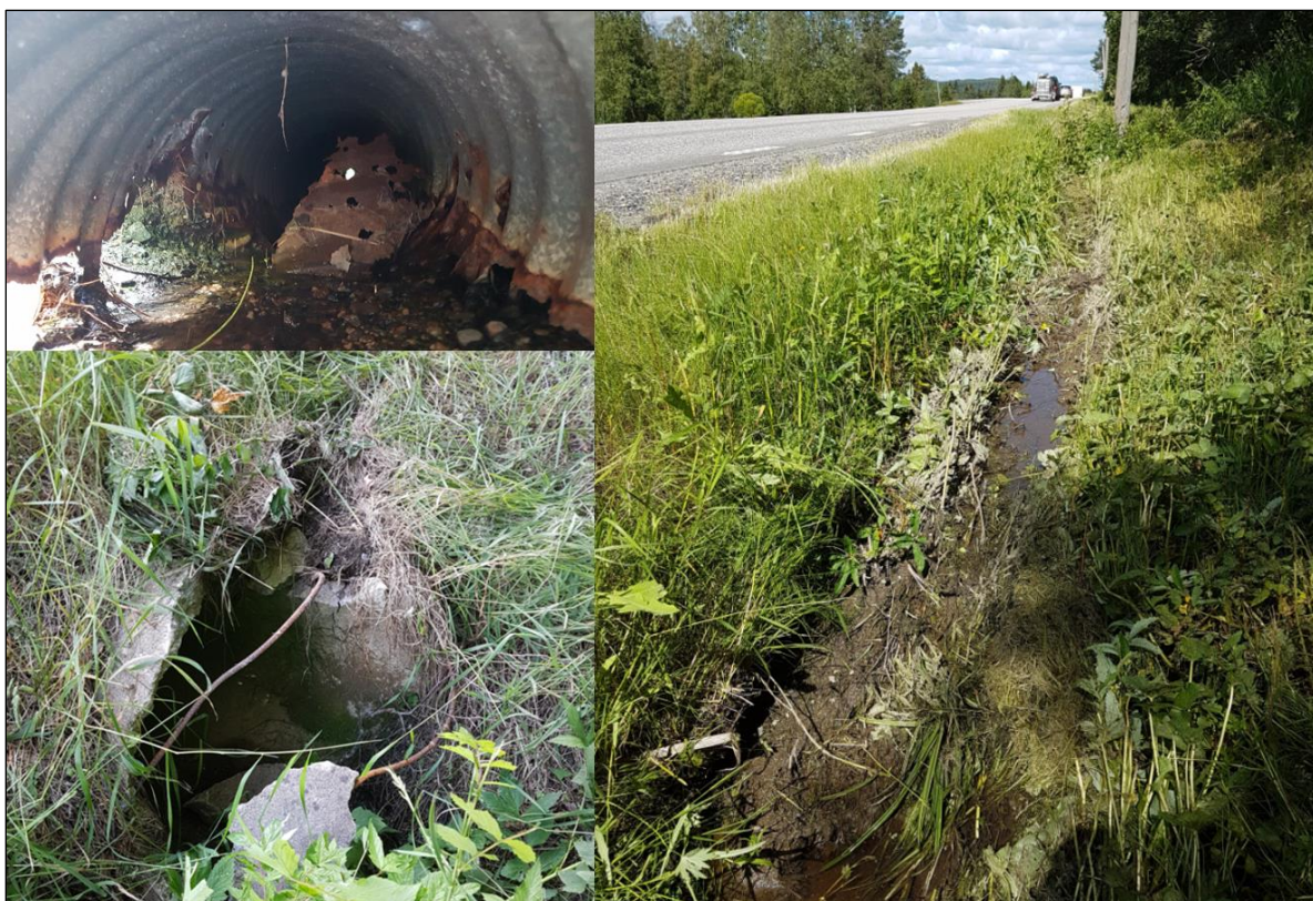
Figur 11. Befintligt vägavvattningsystem i form av trummor och diken är generellt i dåligt skick. Genomrostad plåttrumma och betongtrumma med omfattande skador till vänster. Förekommande öppna diken är längs långa sträckor grunda.
