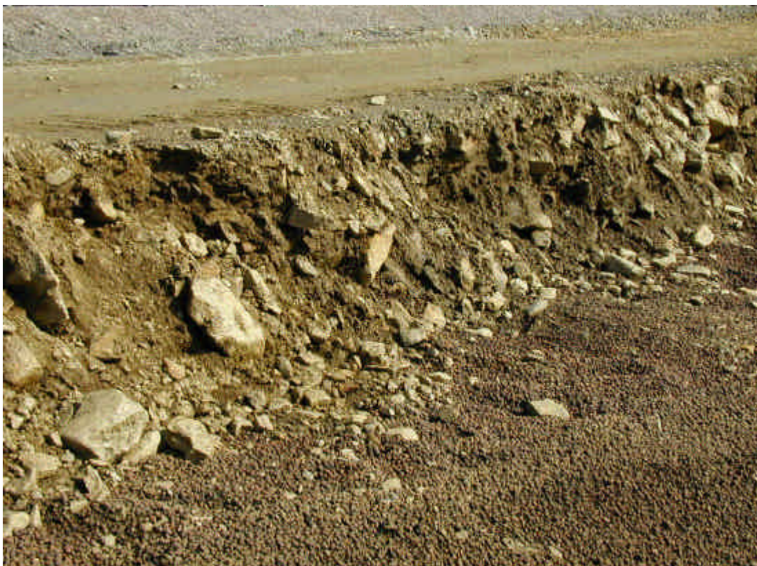
Tveksamt som förstärkningslager!
