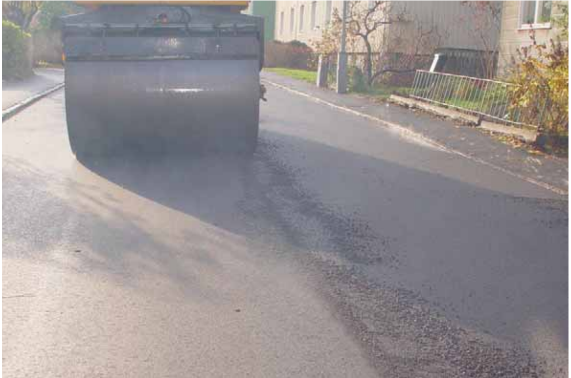
Fel! Lösa stenar ska sopas upp före vältning!
