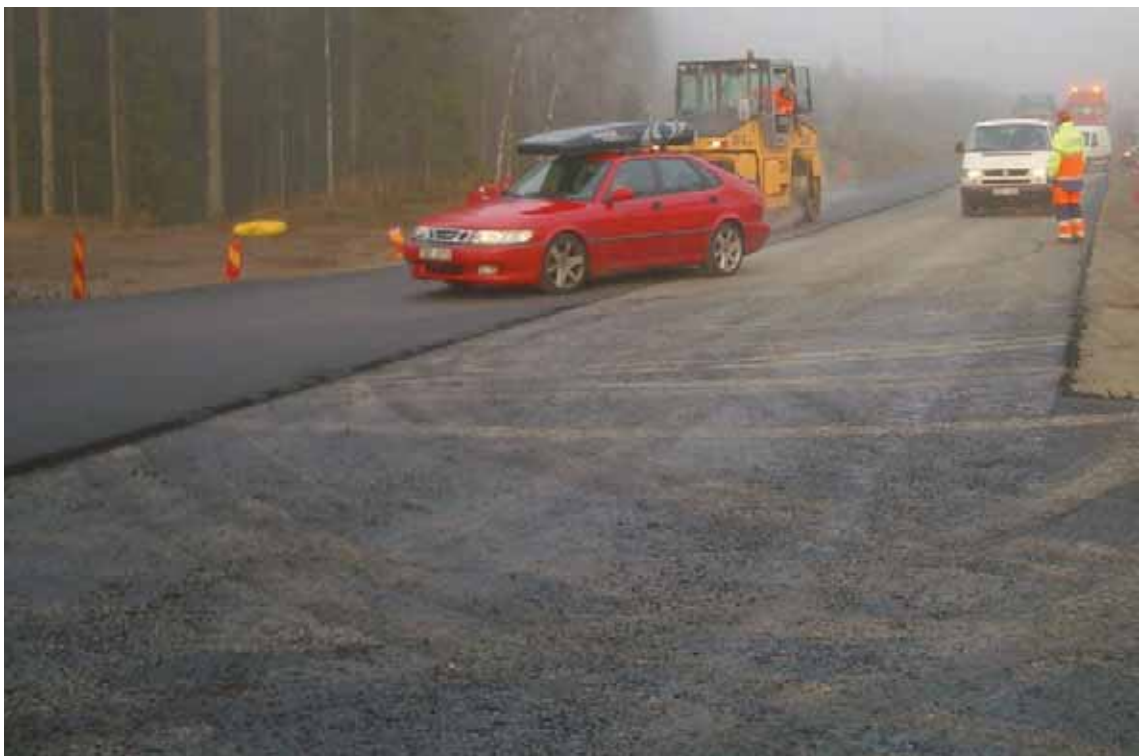
Fel! Dålig trafikplanering! Fogen deformeras av för tidigt trafikpåsläpp. Beläggningen får inte trafikeras förrän den svalnat så mycket att spår inte uppkommer.
