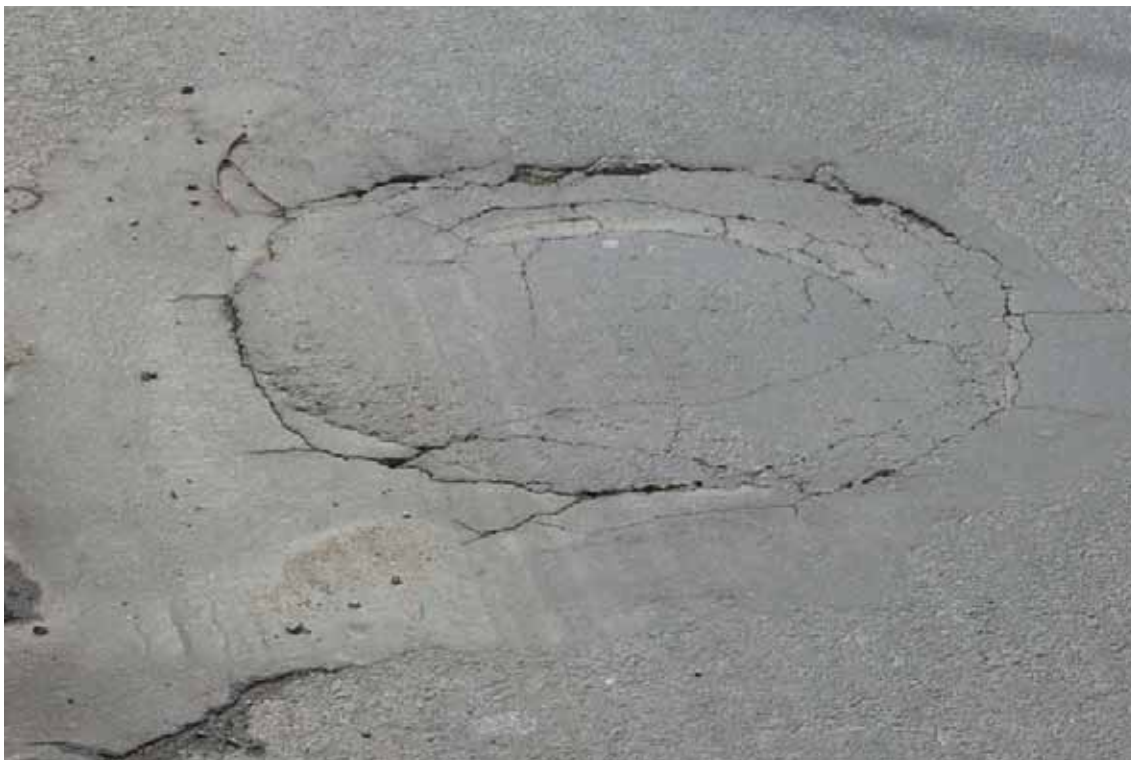
Fel! Ej godkänd överläggning av brunn.
