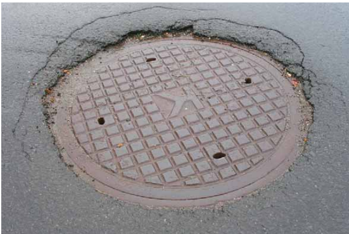
Fel! Brunn skall höjas före beläggning.
