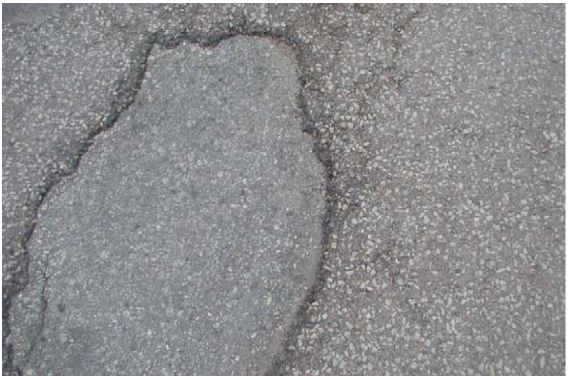
Dålig klistring kan leda till avflagning.
