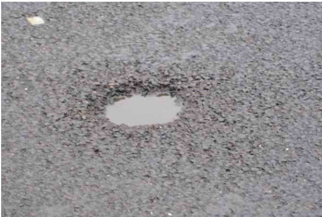
Fel! För låg brunnsbetäckning.
