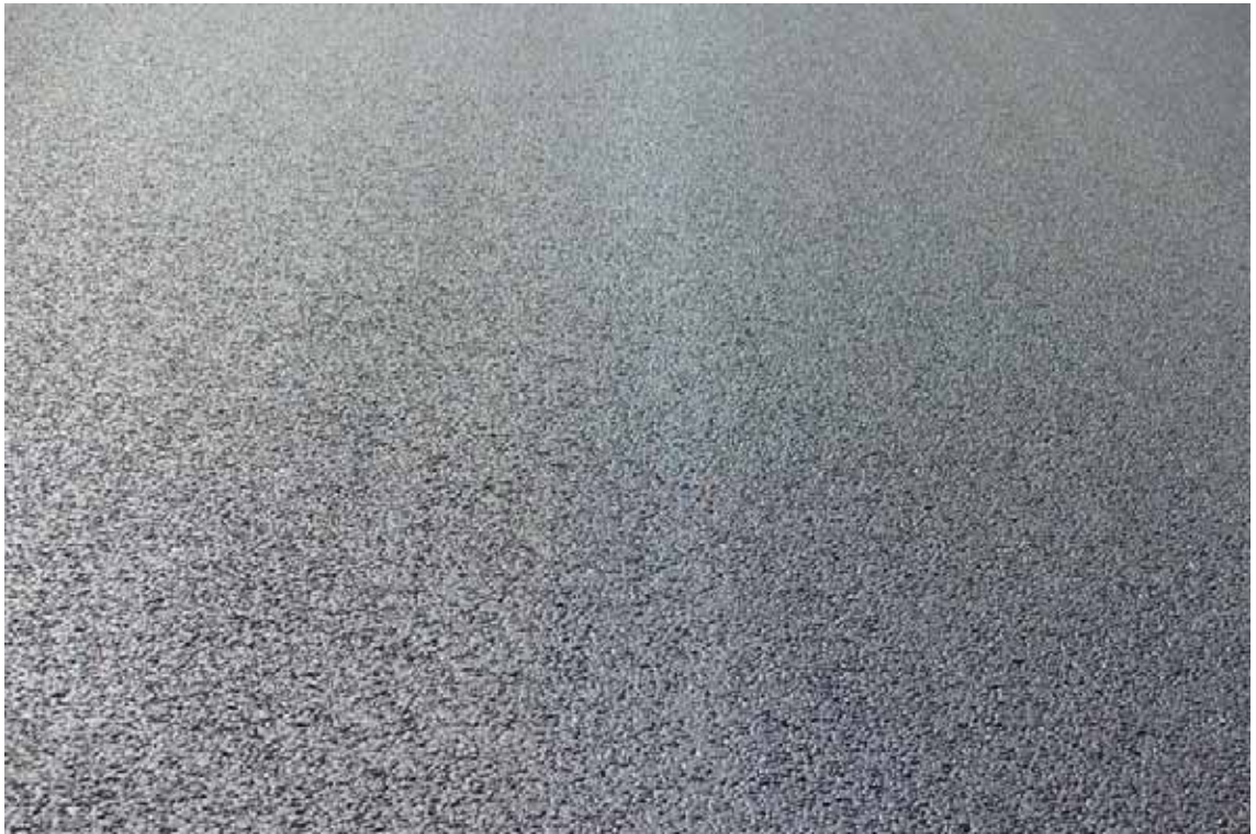
Rätt! Skolexempel på en närmast osynlig längsgående fog.
