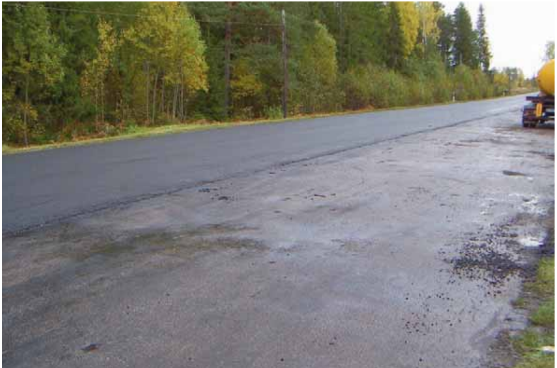
Fel! Sölig och dåligt städad sidoanläggning.
