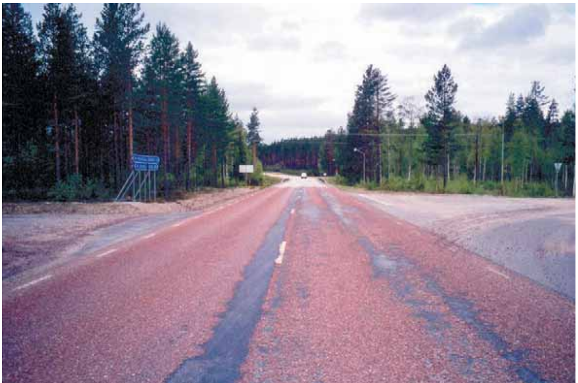
Fel! Stensläpp på grund av felaktigt utförd ytbehandling. Troligtvis har det regnat på förseglingen så att den inte har fällt ordentligt med följd att stenmaterialet släpper.
