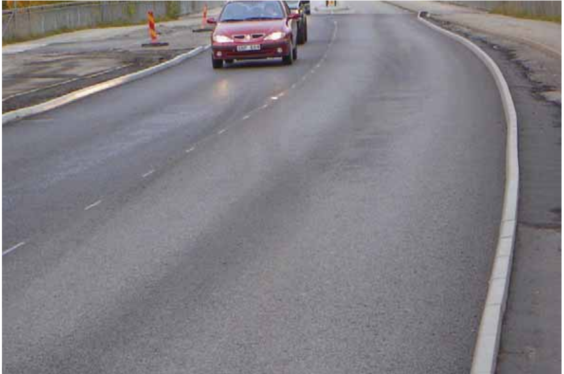
Fel! Spår efter trafik på varm massa som ger upphov till skador.
