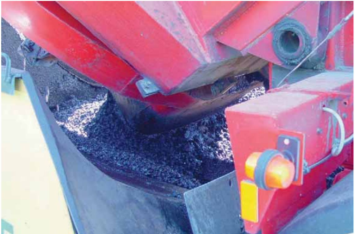
Rätt! Mottagning med trågplåt. Massan rinner ned på matarbandet.
