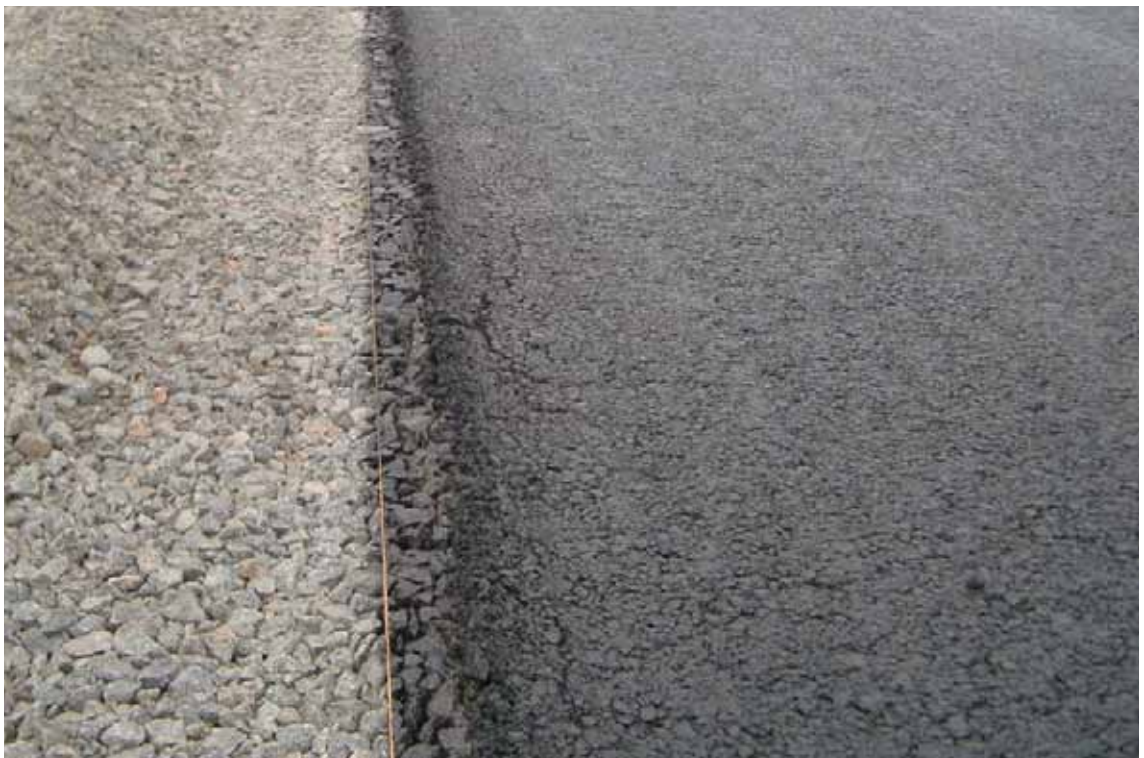
Fel! Våltsprickor! Det obundna bärlagret ligger för högt vilket medför att beläggningen blir för tunn för att klara rätt nivå på färdig väg. Kontrollera att färdiga nivåer är rätt innan nytt lager påförs.
