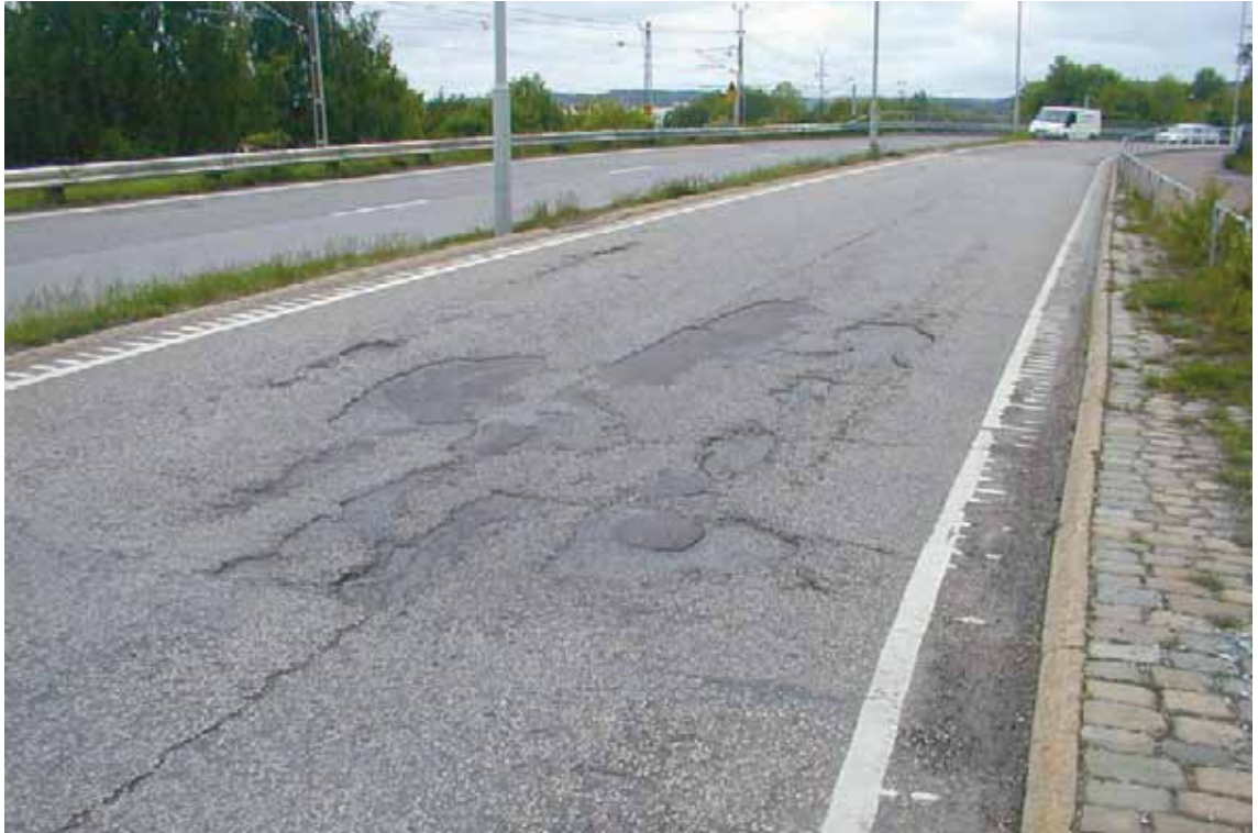
Fel! Avflagning. Lassbyte i kombination med dålig klistring.
