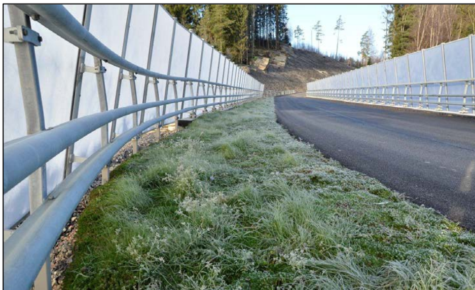
Figur 37. Kombinerad körbro och faunabro över E45. Här med en lågväxande vegetation i nivå med körbana för bron. Liknande åtgärd föreslås för bro över allmän väg vid Fagered, bro 6. Foto: Mats Lindqvist.
