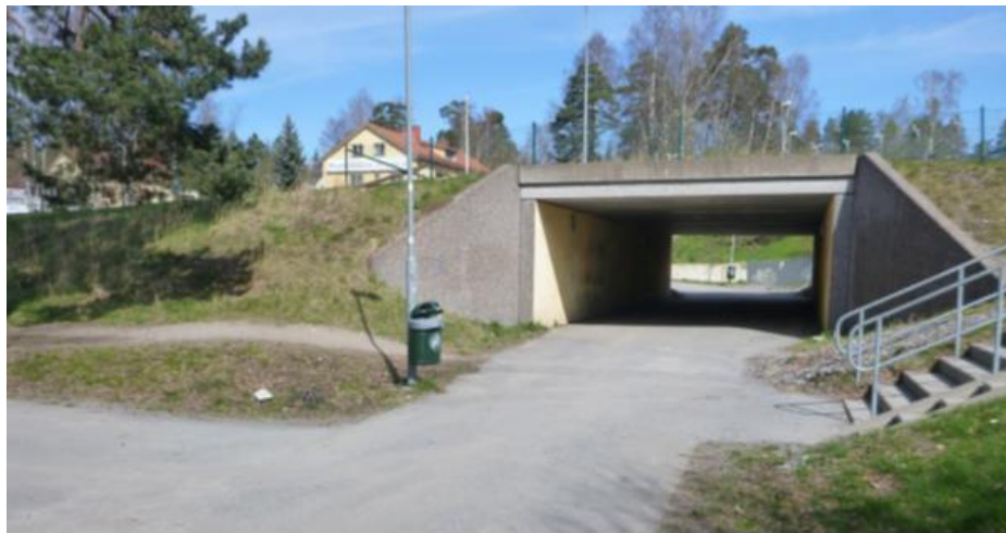
Figur 19 Den enda planskilda korsningen längs sträckan är gångpassagen vid Grisslinge havsbad, vilken är sliten och mörk.
