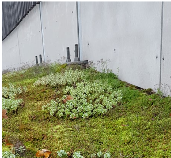
Figur 43 Exempel på befintlig sedummatta längs Göteborgsvägen.
