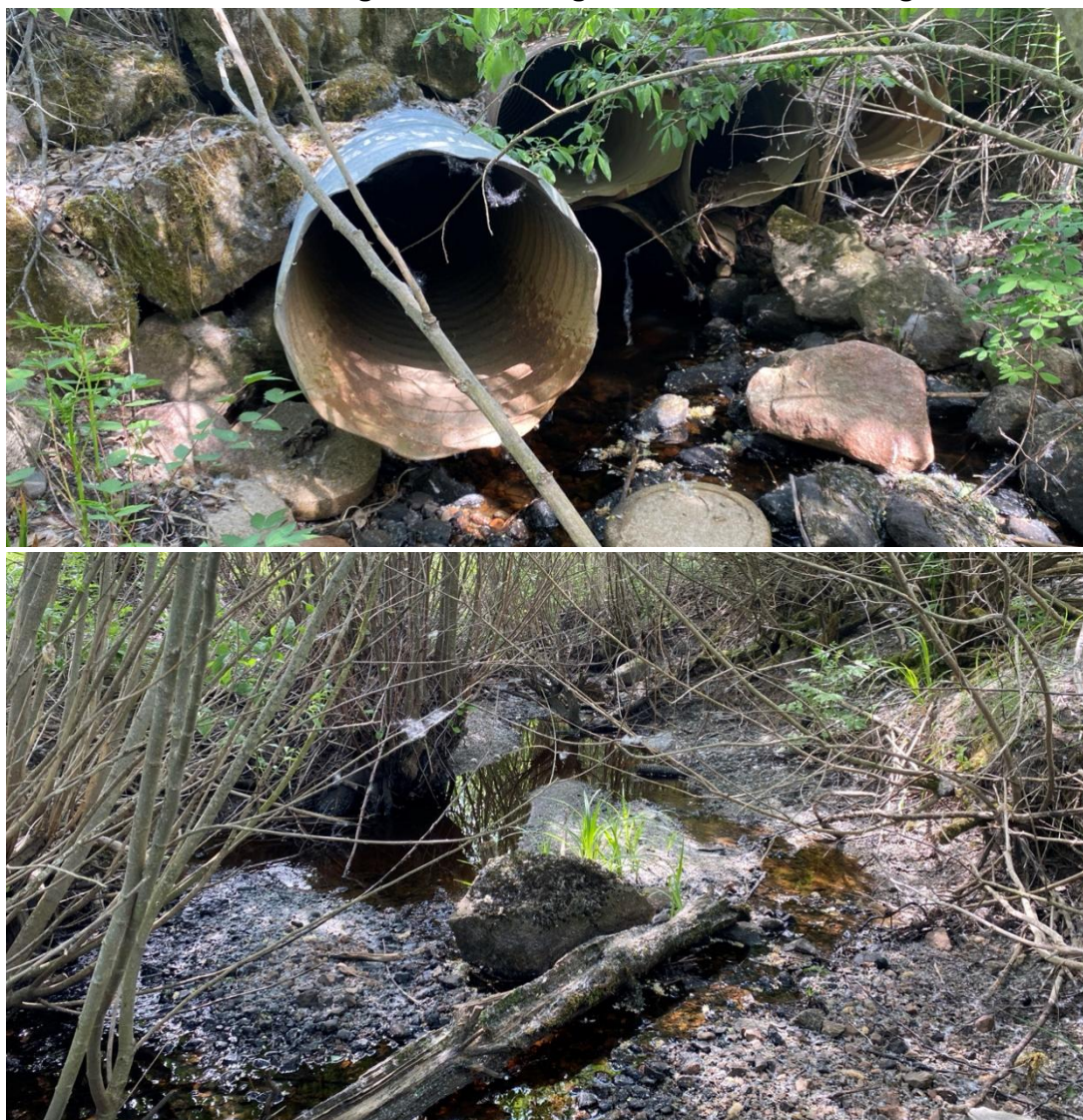
Figur 2. Underdimensionerade vägtrummor i dåligt skick samt vattendragsfåran i anslutning direkt nedströms. Foto från västra sidan om befintlig järnväg i Alsike.
