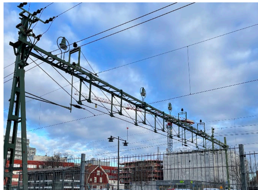
Figur 68. Kontaktledningsbrygga med karaktäristisk grön kulör och armaturer i båg.
