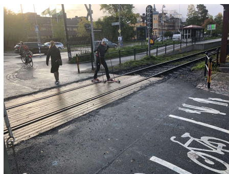
Beläggningen i plankorsningen är undermålig
