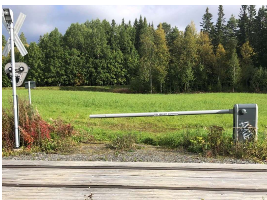
Bommen är inte horisontell. Platsinformation saknas på kryssmärkets baksida
