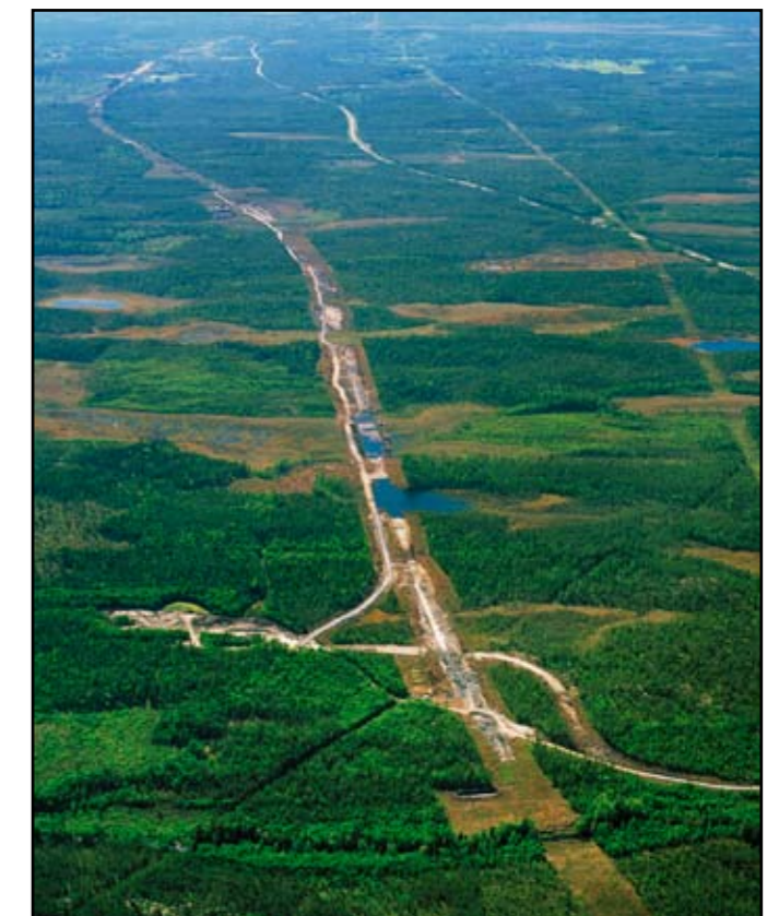
Den nya järnvägen kommer att bli ett nytt inslag i kustlandet. Botniabanan som byggs för närvarande har en bredd som i regel varierar mellan 14 och 50 m. På bilden syns järnvägskorridoren söder om Hörnefors, till höger E4-an. En del av anläggningsytan utmed järnvägen återställs när bygget är avslutat.
