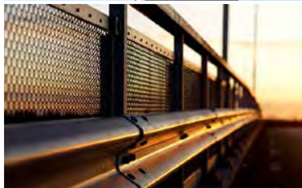
Exempel på genomsiktligt skyddsnet av metall.
