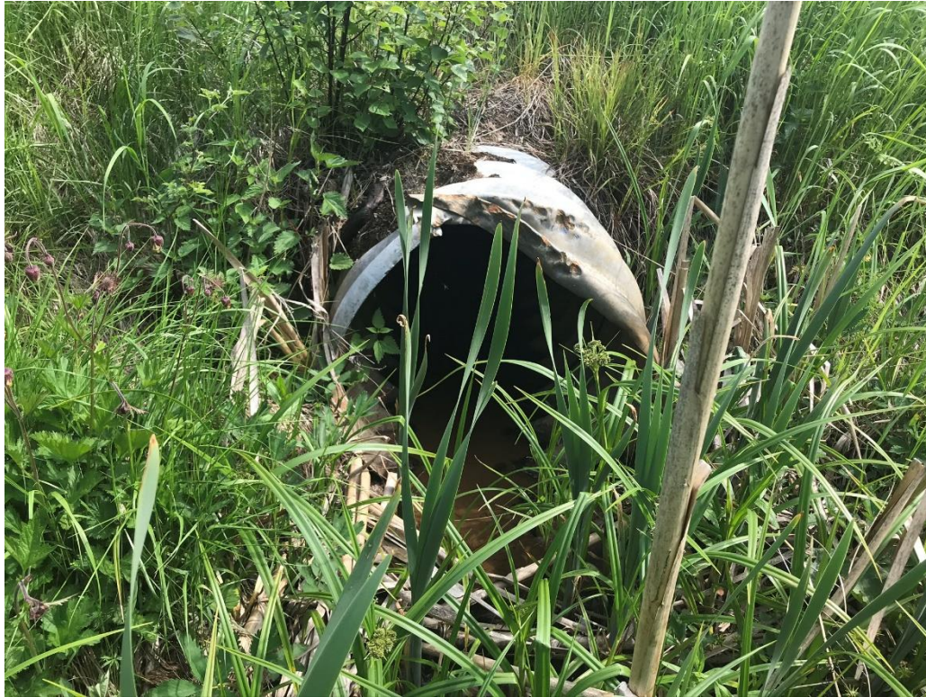
Figur 3. Trumma vid passag av järnvägen. Diameter 500 mm.
