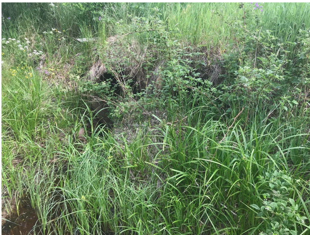
Figur 8. Två betongtrummor, diameter 1000 mm, uppströms järnvägspassage vid gammal väg längst järnvägen
