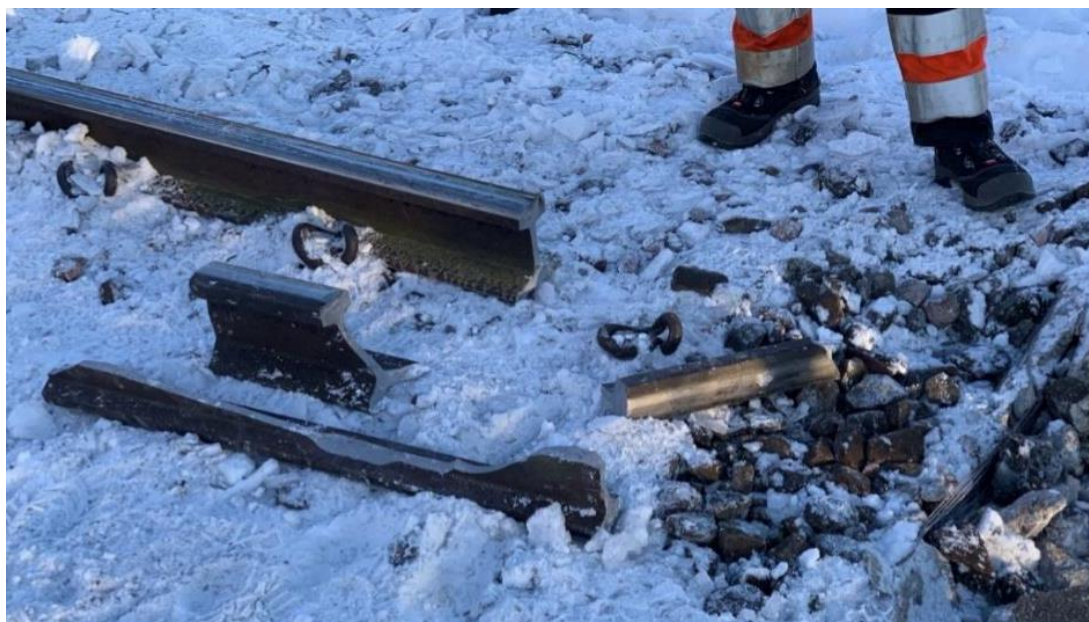
Figur 16. Rälsbrott på sträckan Kiruna-Gällivare i februari 2019 som ledde till urspårning av godståg och skador på anläggning och vagnar. Den kalla temperaturen på -31^{\circ}\text{C} bidrog till rälsbrottet. Foto: Trafikverket.
