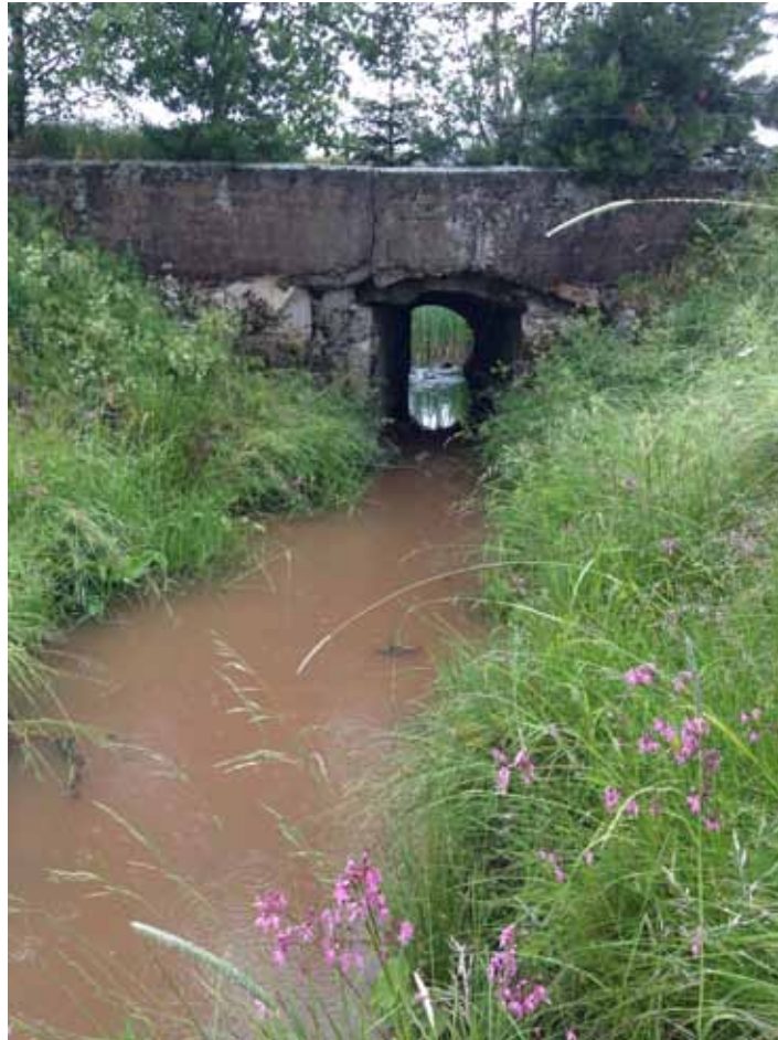
Bild 8.1.1 Stenbro och öppet vattenförande dike söder om järnvägen.
