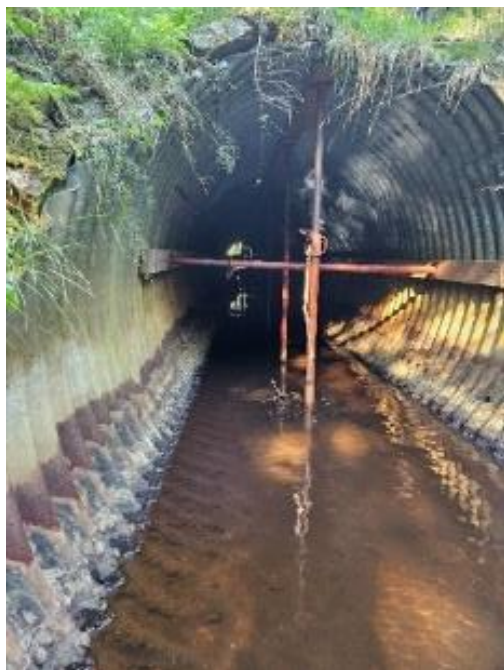
Figur 11. Rörbron genom vilken Veån flyter under E4. Röret har korrosionsskador och stöttas invändigt. Foto: WSP 2025-08-27.
