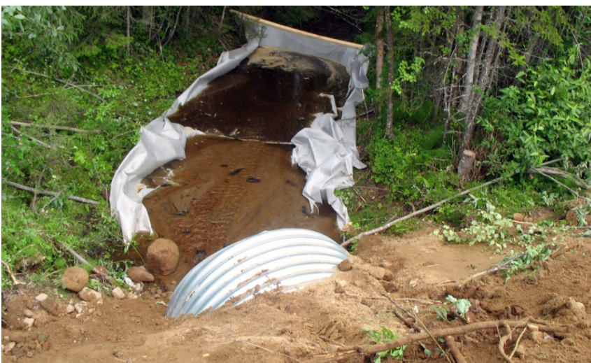
Figur 21. Exempel där geotextil lagts ut för att samla upp sediment vid anläggande av trumma. (Källa: Trafikverket, 2014.)
