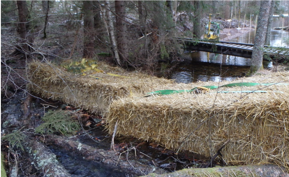
Figur 22. Exempel där halmbalar lagts ut för att dämna vattenflödet och samla upp sediment vid arbetet i vattenområden. (Källa foto: Trafikverket, Agne Gunnarsson.)
