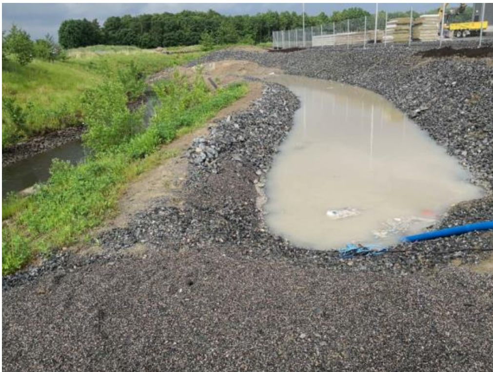
Figur 28. Exempel på tillfällig damm (källa: Swedish hydro solutions. 2021).
