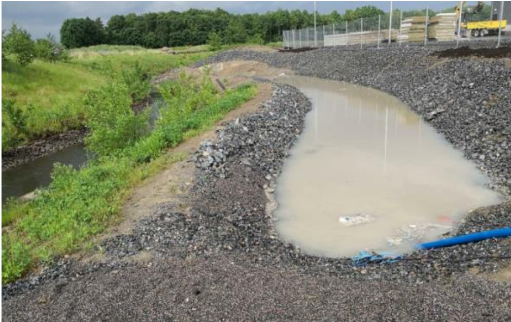
Figur 45. Exempel på tillfällig damm (källa: Swedish hydro solutions. 2021).
