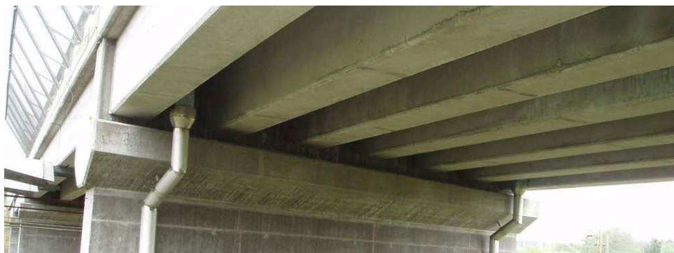
Figur 30. Bro med prefabricerade betongbalkar över järnväg norr om Osby. Foto från BaTMAn
