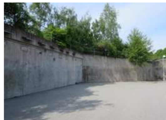
Figur 78. Befintlig betongvägg ger inte ett omhändertaget uttryck. Foto: WSP
