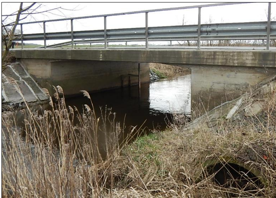
Figur 7. Foto av befintlig vägbro över Vinne å. I det nedre högra hörnet syns ingången till ett av betongrören. Betongröret går hela vägen till andra sidan bron bakom rambenet och det finns ett likadant betongrör vid det andra landfästet.
