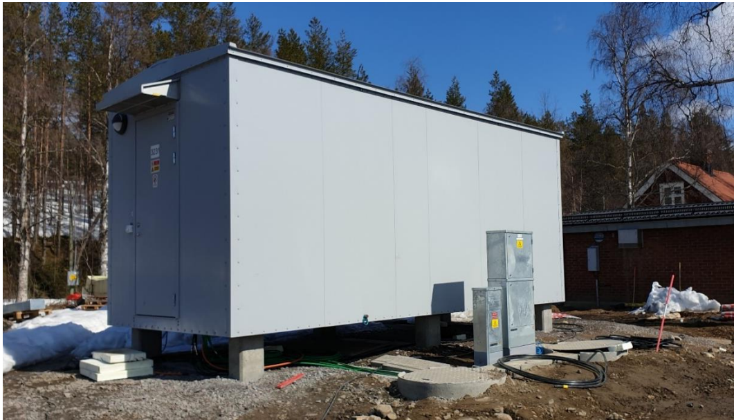
Figur 5.3.1-1. Teknikhus för ERTMS.
