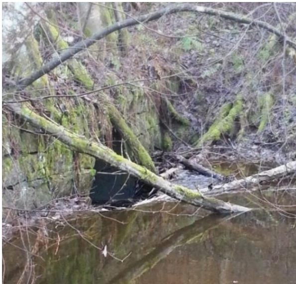
Figur 16. Visar exempel på att trummor för genomledning av vatten är undermåliga; här trumma med fördämt inlopp till trumma vid Broängsbäcken.
