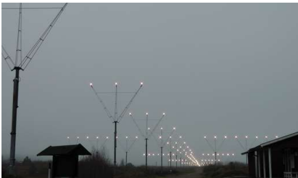
Figur 28 Norra Ijuslinjen vid Växjö flygplats. Foto: Lars Ehnбом
