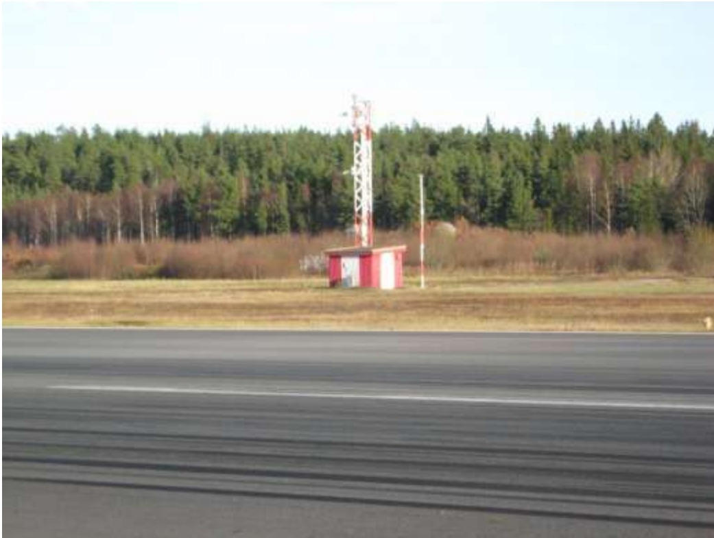
Figur 17 (Glide path) Glidbana, sänder höjdinformation till flygplanen vid landning i dåligt väder. Används tillsammans med LOC, samt DME, distansmättningsutrustning
