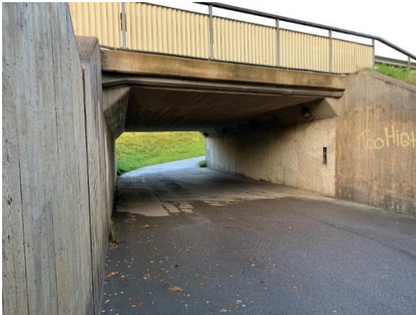
Figur 4:13. Bro 2-1369-1 för väg 260 sedd från angränsande bro. Vingen för -2 skymtar till vänster.
