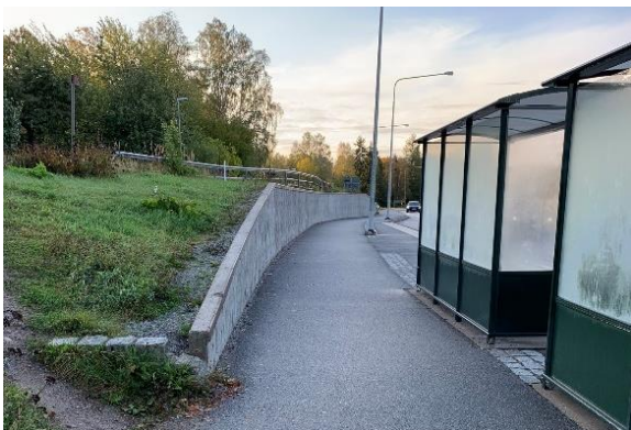
Figur 4:15. Stödmur vid busshållplats Sofieberg, nedanför Önskegången. Vägräcket för den övre vägen (Önskegången) står i fyllning cirka 0,5 meter från murens krön som närmast.
