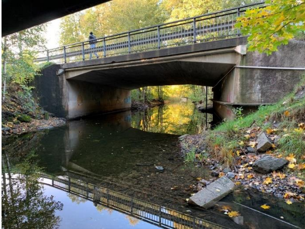
Figur 4:11 Bro 2-261-1 sett från öster. I bildens överkant, rakt över fotografen, skymtar fjärrvärmeledningen. Kantiga stenblock hitom bron kan möjligtvis vara rester från äldre bro från 1918. Skredet av släntkon finns noterat i BaTMan.
