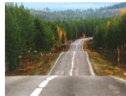
Figur 37. Vågig profil undviks. (Vägverket 2006).
