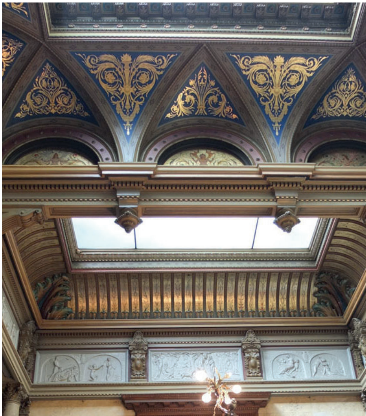
FIGUR 6.6: Taklanternin med etsat glas ramas in av förgyllda takfriser och målningar. Fast inredning, friser av stuck och konstnärlig utsmyckning som dessa är mycket känsliga för spänningar och sprickor som uppkommer av sättningar.
