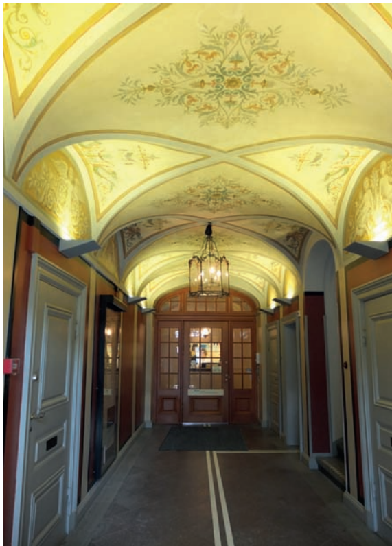
FIGUR 6.7: Bemålade kryssvalv i Sahlgrenska huset, byggnadsminne enligt kulturmiljölagens tredje kapitel. Byggnadselement som dessa är mycket känsliga för sättningskador.
