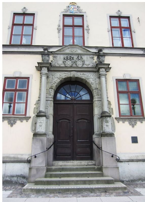
FIGUR 6.8: Unik kalkstensportal som smyckar huvudentrén till Residenset, byggnad som är statligt byggnadsminne. Om en skada uppstår på portalen och delar av denna faller ner, kan oersättlig skada uppstå. Om delar i portalen behöver rekonstrueras påverkas byggnadens autenticitet, vilket inverkar negativt på både dess kunskapsvärde och upplevelsevärde.
