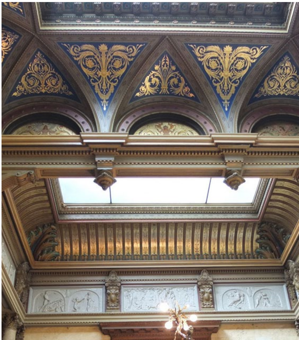
FIGUR 6.6: Taklanternin med etsat glas ramas in av förgyllda takfriser och målningar. Fast inredning, friser av stucc och konstnärlig utsmyckning som dessa är mycket känsliga för spänningar och sprickor som uppkommer av sättningar.
