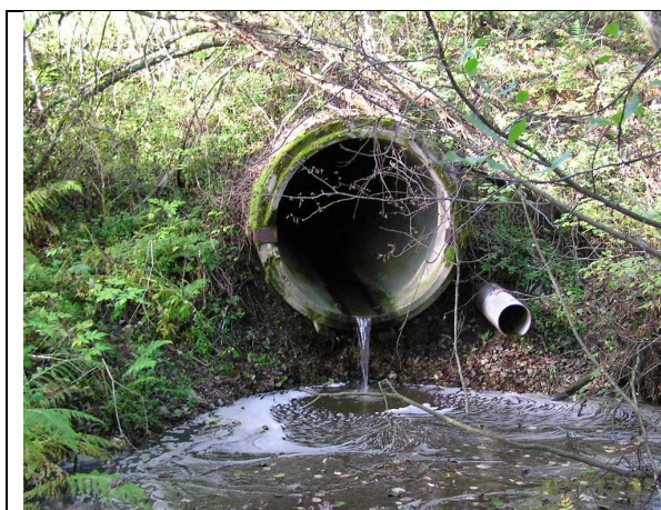
Foto 3.4.1. Trummans utlopp, 1600 mm, under befintlig gångväg vid järnvägens sektion 334+175, Tingstagärdesbäcken. Node 5 i figur 3.4.2
