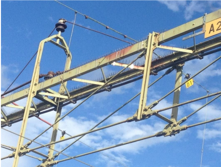
Bild 1 Kontaktledningsbrygga av äldre typ med delvis monterade fågelavvisare
