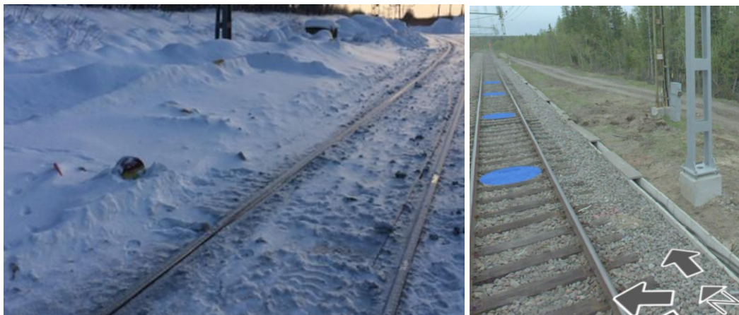
Figur 7.2.5.3. Exempel på vanliga skador i samband med vintertjänster, krökt växelklot (vänstra bilden), trasiga kanalisationslock (högra bilden).
