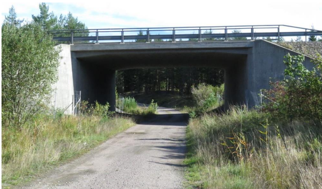
Bild 7. Port under E22 mellan Söderköping och Valdemarsvik. Ett exempel på utformning av port som även möjliggör viltpassage under vägen. Djuren styrs in i porten genom att viltstängslet utmed E22 viker ner mot portöppningen.
