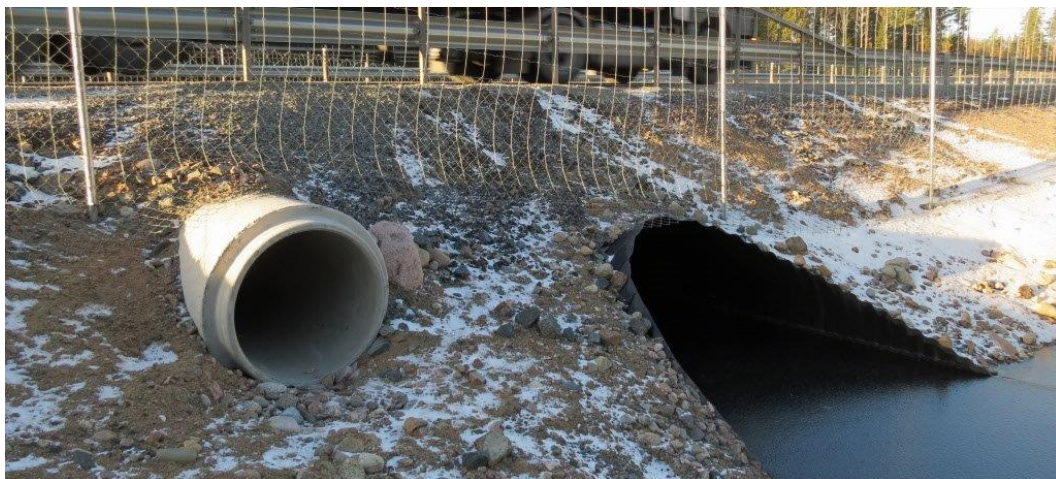
Bild 8. Exempel på torrtrumma intill vattendrag. Bilden är tagen vid Dunsjöbäcken, nya väg 56 mellan Stingtorpet och Tärnsjö i Heby kommun.
