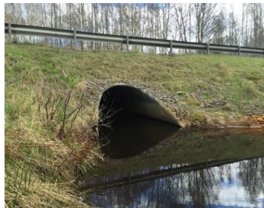
Bild 3. Betongtrumma, april 2016. Diameter 2000 mm.
