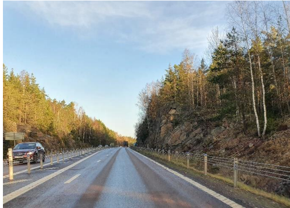
Figur 4.7. Vy från söder mot norr visar befintlig bergskärning i den norra delen av sträckan.
