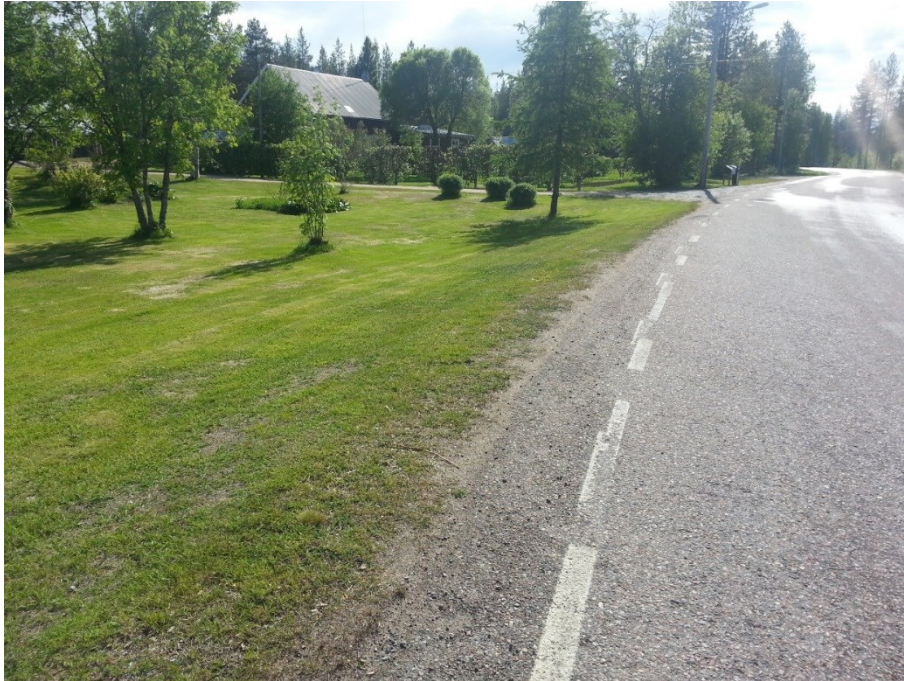
Foto 1, I Bjumisträsk ligger vägen i nivå med omgivande terräng och vägdiken saknas.
