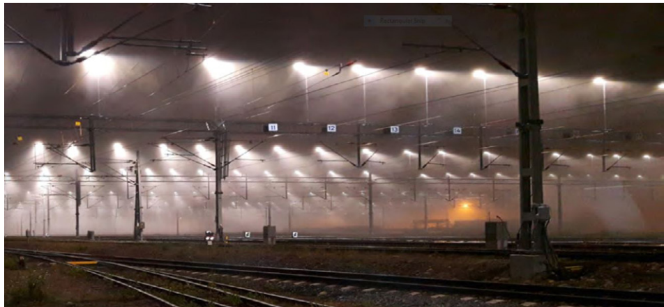
Figur 37. Belysning vid uppställningsspår, Foto från produktblad, Unistreet RW-Bangårdar.
