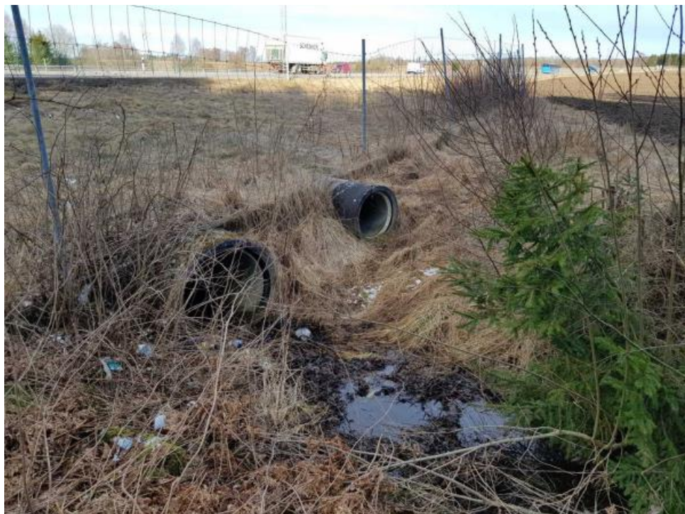
Figur 10: Foto på torrtrumma som kan användas som passage under väg 44 av medelstora däggdjur, belägen strax öst om utredningsområdet. Källa: Miljöwebb landskap
