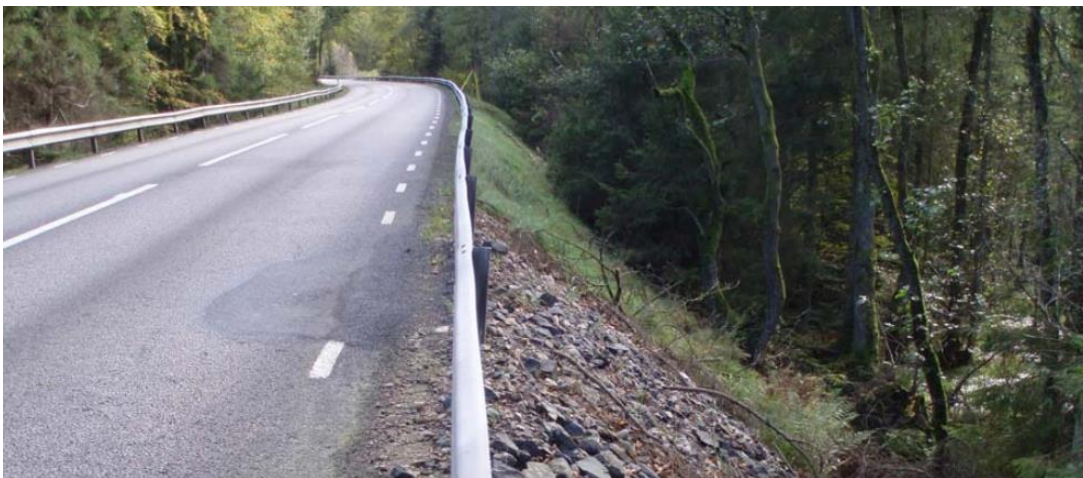
Figur 18 Lagad erosionsskada (Foto: Vägverket Konsult, 2007)
