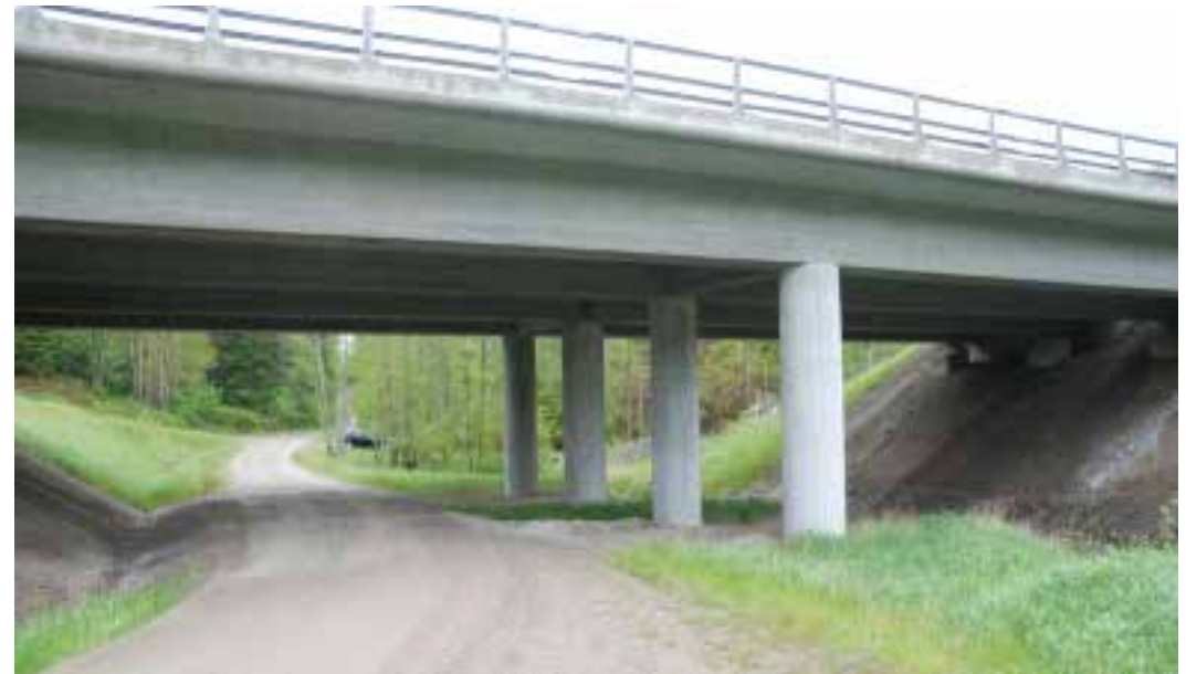
Exempel på en faunanpassad passage i en dalgång med en bäck längs E6 i Bohuslän. Foto: Mats Lindqvist (Trafikverket).
