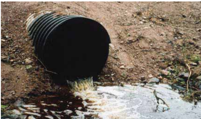
Vägtrumman utgör ett vandringshinder eftersom fisken inte kan ta sig upp för fallet som bildas i trummans utlopp.
