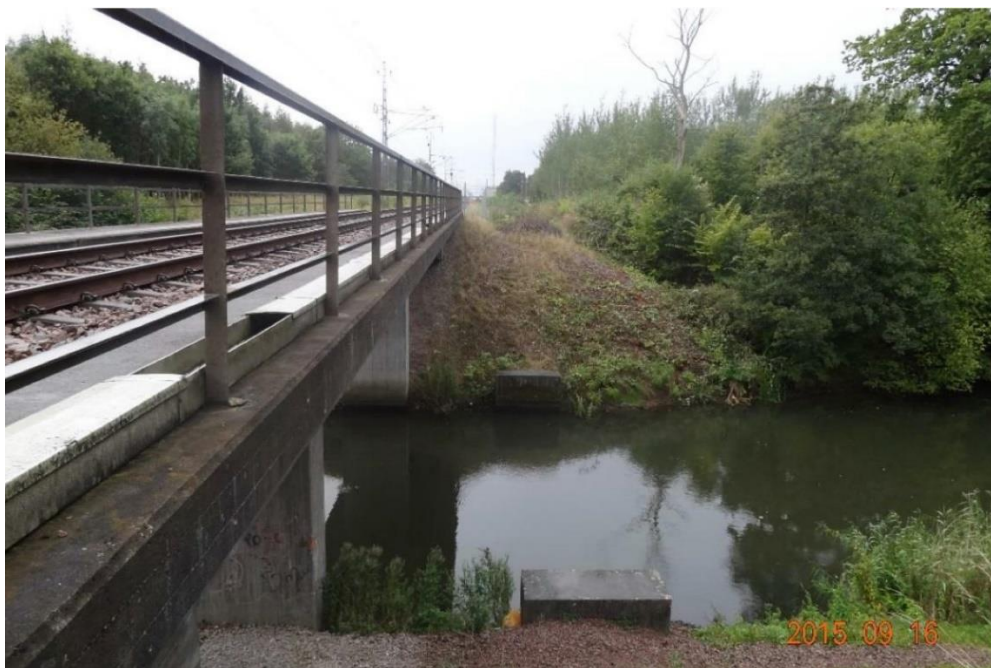
Figur 2. Befintlig Järnvägsbro över Vegeå. Foto taget i sydlig riktning från åns norra strand. Två extra brostöd (från byggnation av befintlig bro) syns till höger i bild.
