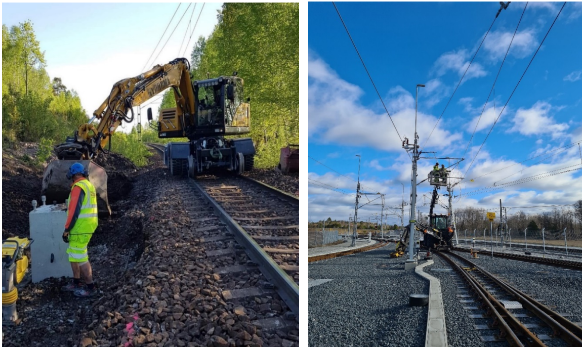
Figur 23 och 24. Exempel på hur kontaktledningsbyggnation går till. Bilden till vänster visar anläggande av grävt fundament. Bilden till höger visar hur man drar kontaktledning. Arbetena bedrivs från spåret. Foto: Jonas Berglind.
