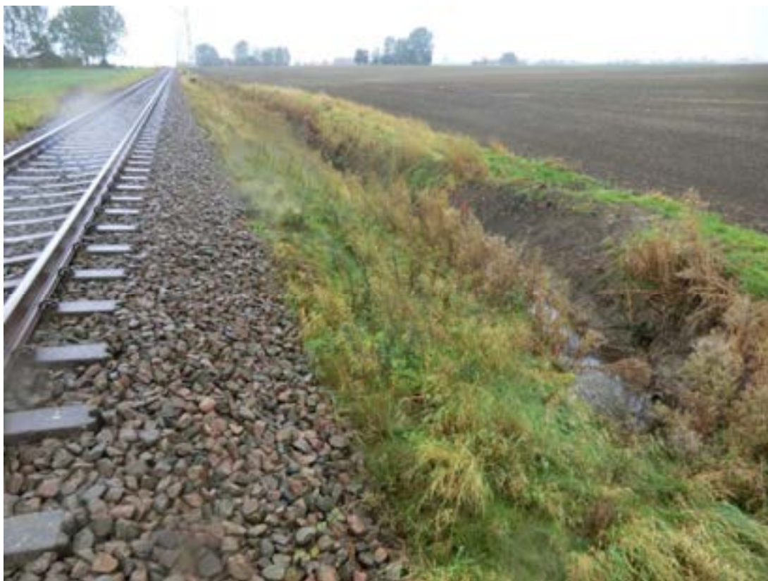
Figur 5.1:2 Diket (objekt 8) som löper parallellt med befintligt spår på en sträcka av ca 85 meter.
