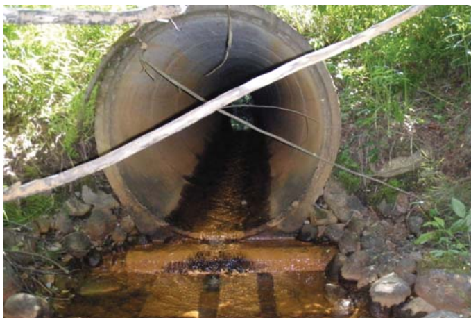
Figur 2.4.4. Av Havs- och vattenmyndigheten (tidigare Fiskeriverket) utpekad vandringshinder, högt stalp, Orrtjärnbäcken. Foto: Havs- och vattenmyndigheten
