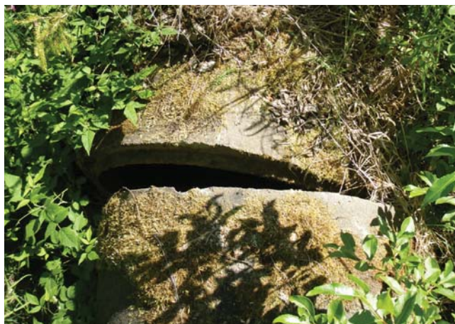
Figur 2.4.5. Av Havs- och vattenmyndigheten (tidigare Fiskeriverket) utpekad vandringshinder, trumringen lossnat i skarven, Brännäsbäcken. Foto: Havs- och vattenmyndigheten
