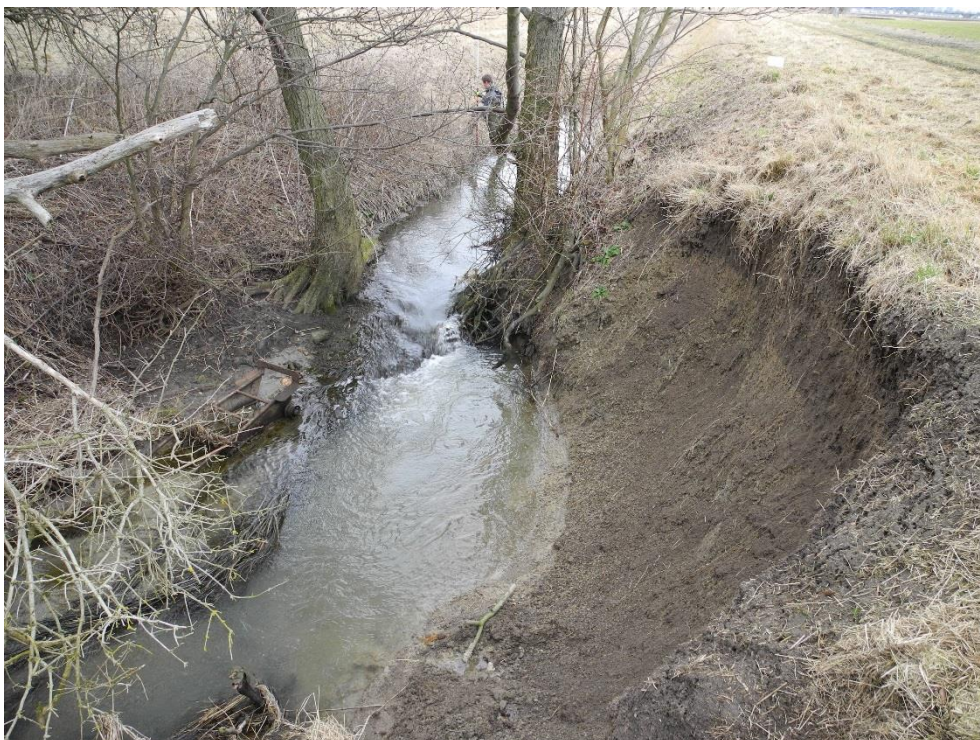
Figur 9.18 Erosion av slänter bidrar till grumling av vattnet. Bild tagen mellan Åkarp och Coyetgården
