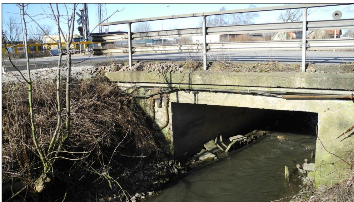
Figur 3.5 Bro vid Alnarspvägen i Åkarp. Bredd varierar mellan 1,7–2,8 m, höjd cirka 1,7 m. Kommer att ersättas av kulvert under Sockervägen med bredd minst 3 m, höjd minst 2 m.
