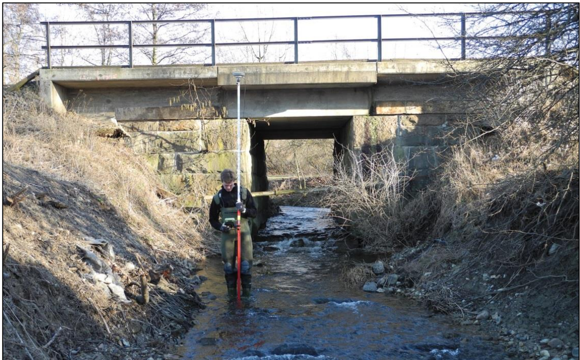
Figur 3.7 Bro vid stambanan i Arlöv. Bredd cirka 2,45 m, höjd cirka 2,7 m. Kommer att ersättas av bro med bredd cirka 4,5 m. I nuläget finns en nivåskillnad på 50-60 cm mellan bottenivån på uppströmssidan och nedströmssidan bron.
