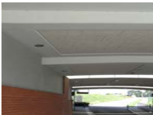
Ljudabsorbenter i tunneltak
