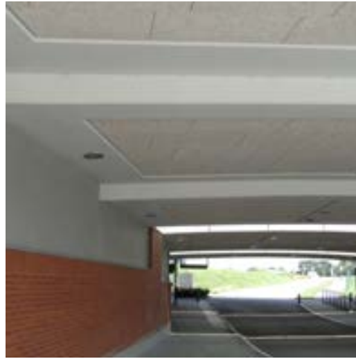
Ovan. Ljudabsorbenter i tunneltak. Falkenberg station.
