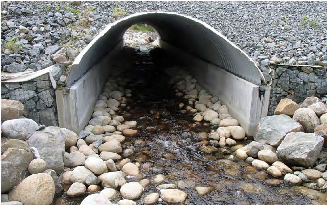
Valvbåge med betongfundament gör det möjligt att återskapa en naturlig botten. Foto: Trafikverket.
