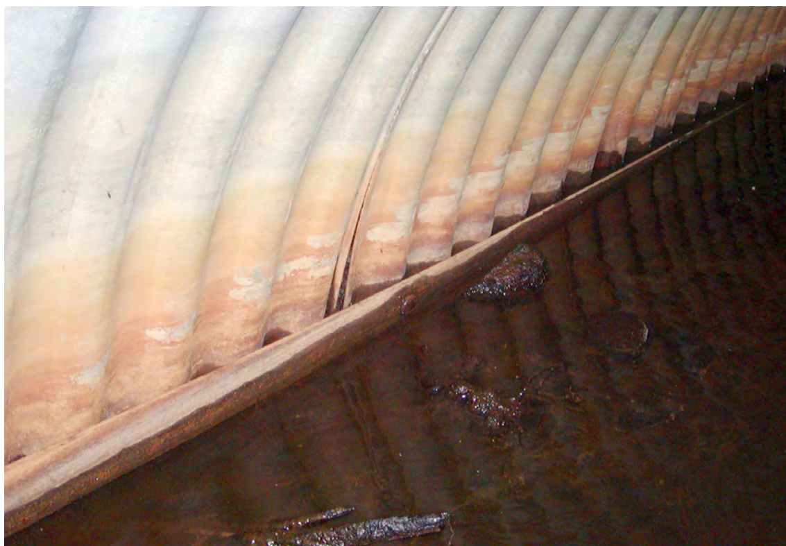
Sättning som orsakat materialskada. Foto: Skogsstyrelsen.
